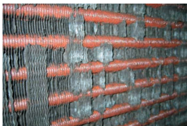
▲無防腐蝕劑保護時，受到嚴重侵蝕的盤管
